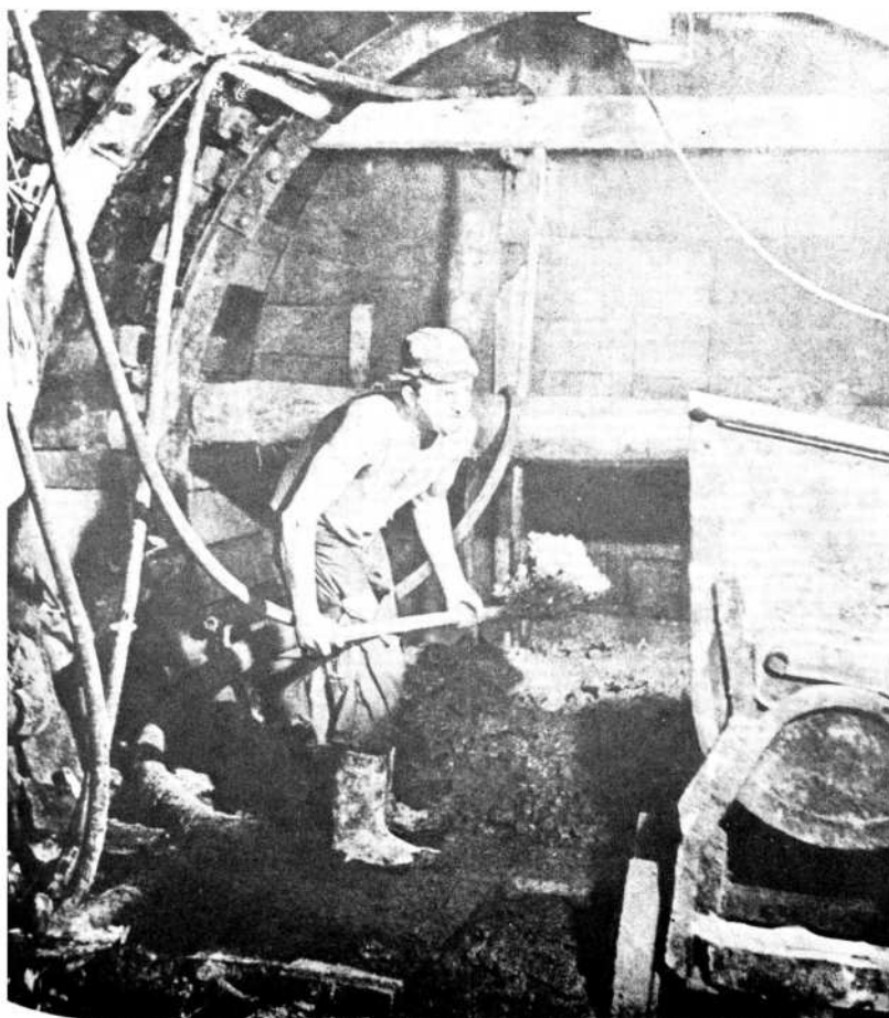
53. Budowa 900-metrowego tunelu pod dnem Wisły dla przewodów ciepłej wody z Elektrociepłowni „Żerań” na Żoliborz
