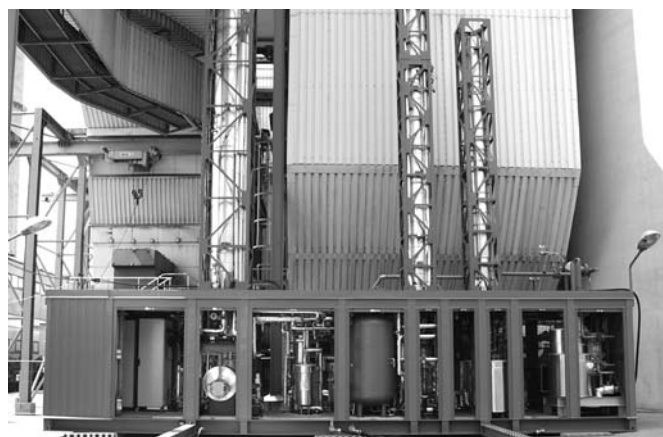
Fot. 1. Kontener Technologiczny podczas fazy rozruchowej
