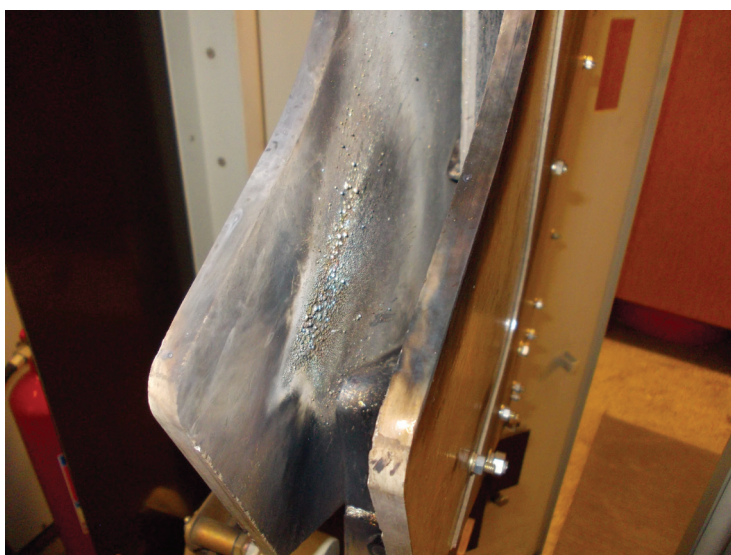
Rys. 9. Ślady działania łuku elektrycznego na elemencie zasilacza trakcyjnego nr 4
