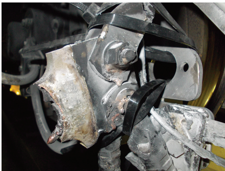
Rys. 10. Rozległe uszkodzenia termiczne odbieraka
