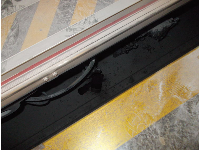
Rys. 3. Wypalona osłona odbieraka prądu – widok od strony peronu stacji Źródło: opracowanie własne
