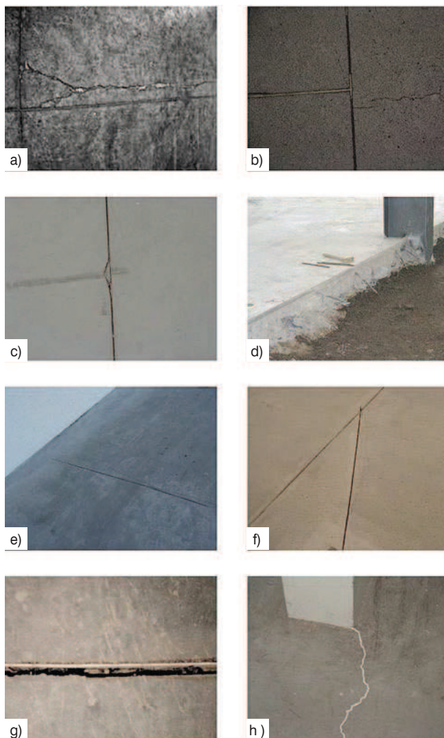
Rys. 3. Przykłady rys spowodowanych wadliwymi dylatacjami: a) rysy wzdłuż zbyt późno naciętej dylatacji, b) niewłaściwy układ nacięć przeciwskurczowych, c) brak ukosowania krawędzi dylatacji nacinanych, d) krzywo osadzone dyble, e) źle wykonane nacięcia przeciwskurczowe, f) nacięcia wykonane pod zbyt ostrym kątem, g) odspojenia kitów wypełniających wskutek niewłaściwej aplikacji, h) brak dylatacji wokół słupów nośnych
