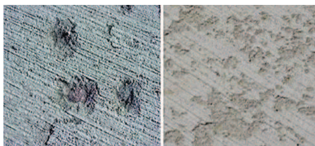
Rys. 6. Przykłady występowania odprysków na powierzchni posadzki przemysłowej
