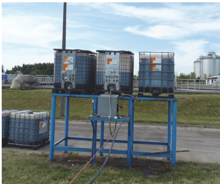
Rys. 1. Instalacja do dawkowania preparatu Brenntaplust VP1
