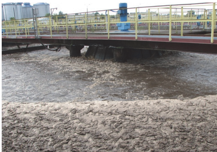
Rys. 8. Strefa nitryfikacji I Fig. 8. Nitrification zone
