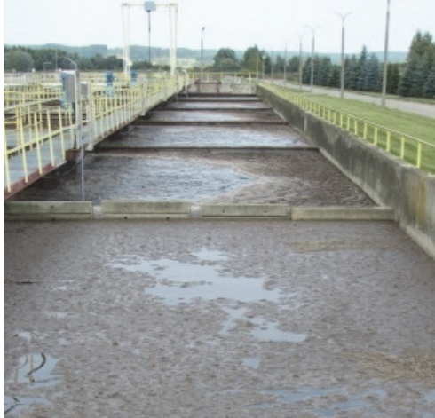
Rys. 6. Komora osadu czynnego Fig. 6. Sludge activated chamber
