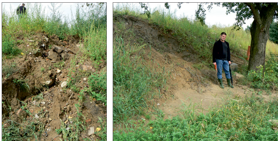
Ryc. 3. Ślady skoncentrowanego spływu powierzchniowego z powierzchni nasypu: A. Rozcięcie erozyjne na skarpi nasypu (fot. K. Mostowik); B. Rozcięcie erozyjne oraz zerwa ziemna w skarpi nasypu (fot. K. Mostowik)
