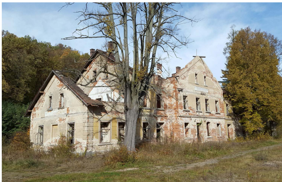
Il. 11. Ruiny budynku dworca na stacji granicznej w Hermanicach. 20 X 2021 r. Fot. Paweł Jakuboszczak.
