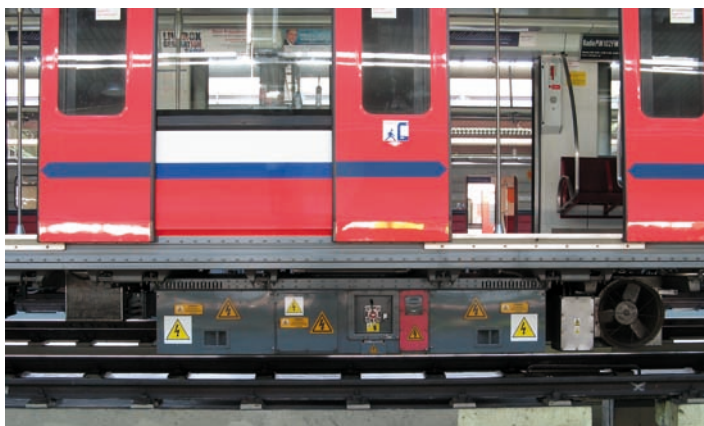
Aparatura elektryczna w wagonie Metropolis, STP Kabaty, 23.09.2006 r.
