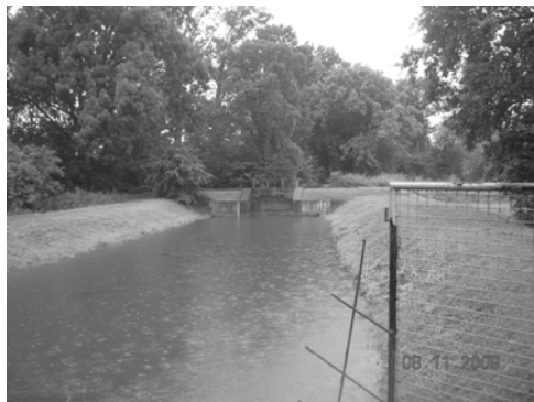
Fot. 1. Mała elektrownia wodna w Klislinie na rzece Osobłoga – jaz zastawkowy (fot. M. Wiatkowski )
