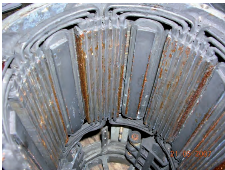
Rys. 4.25. Silnie skorodowane blachy krzemowe nabiegowników stojana prądnicy-rozrusznika GS-18
